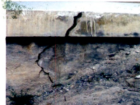
图 7 年家村 2 号桥桥台侧墙竖向裂缝
