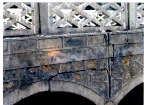
图 9 甘家沟桥拱上侧墙裂缝
