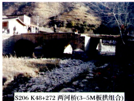
图11 拱圈严重变形的两河桥
