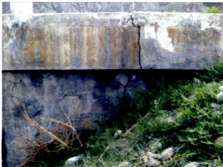
图 6 年家村 3 号桥桥台侧墙竖向裂缝
