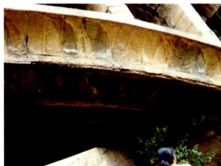
图13 马街桥腐蚀严重
