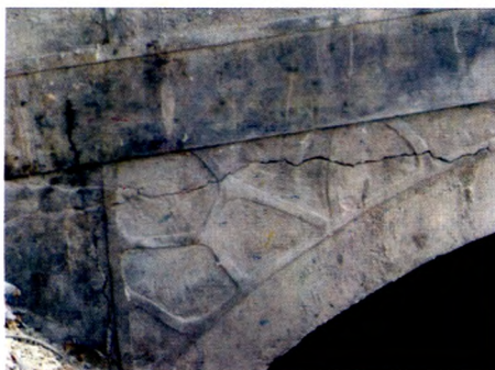
图 8 甘家沟桥拱上侧墙裂缝
