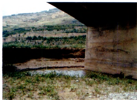
图 3 祁山大桥河床下淤积
