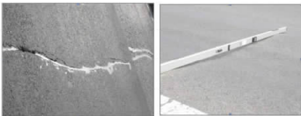
图1 湖南省高速公路路面病害示例
